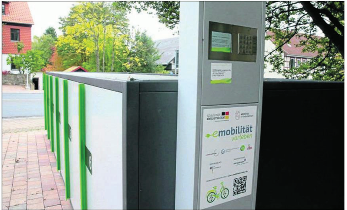
Mini-Garagen mit Ladefunktion: Diese Station für die Pedelects genannten Elektro-Fahrräder wurde in Dransfeld in der Parkanlage Köterwelt aufgestellt. Foto: Schröter
